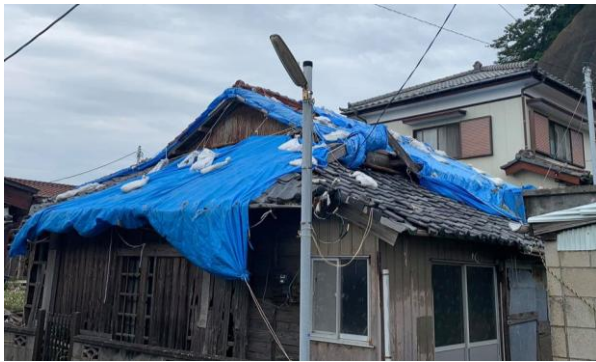
日時が経過して劣化したブルーシート
