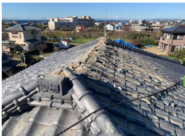
損傷箇所（活動前）
