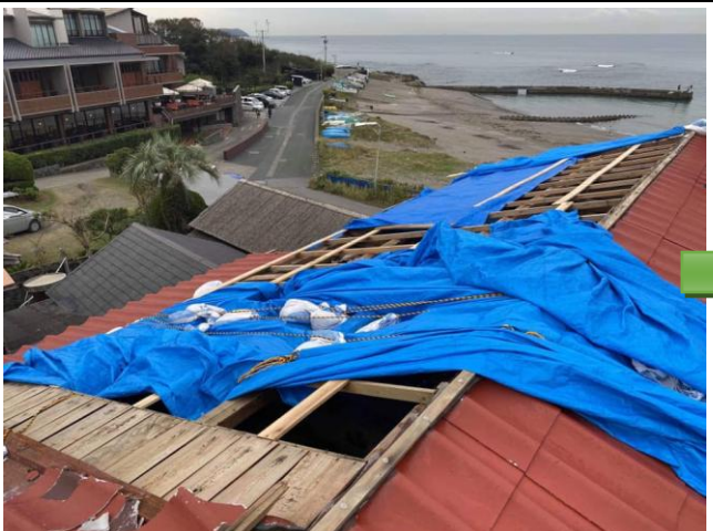
強風等で剥がれたブルーシート
