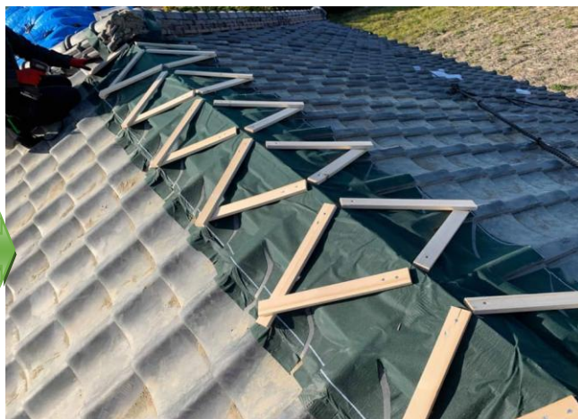
損傷箇所（活動後）
